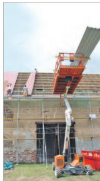
Dachpaneelen-Deckung als Untergrund für den Aufbau der großflächigen Photovoltaik-Anlage auf dem alten Stadl beim E-Werk.
